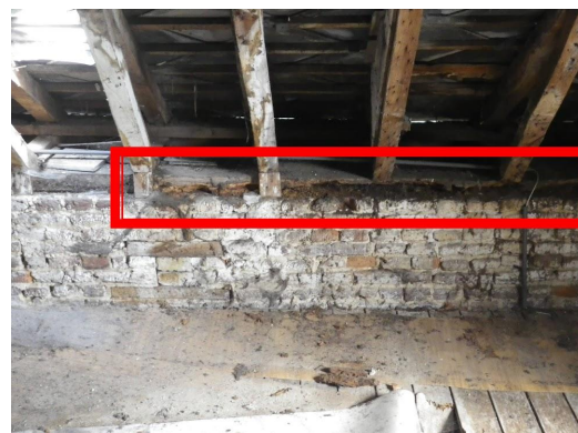
Ingerotte muurplaat als gevolg van een vroeger lek.
