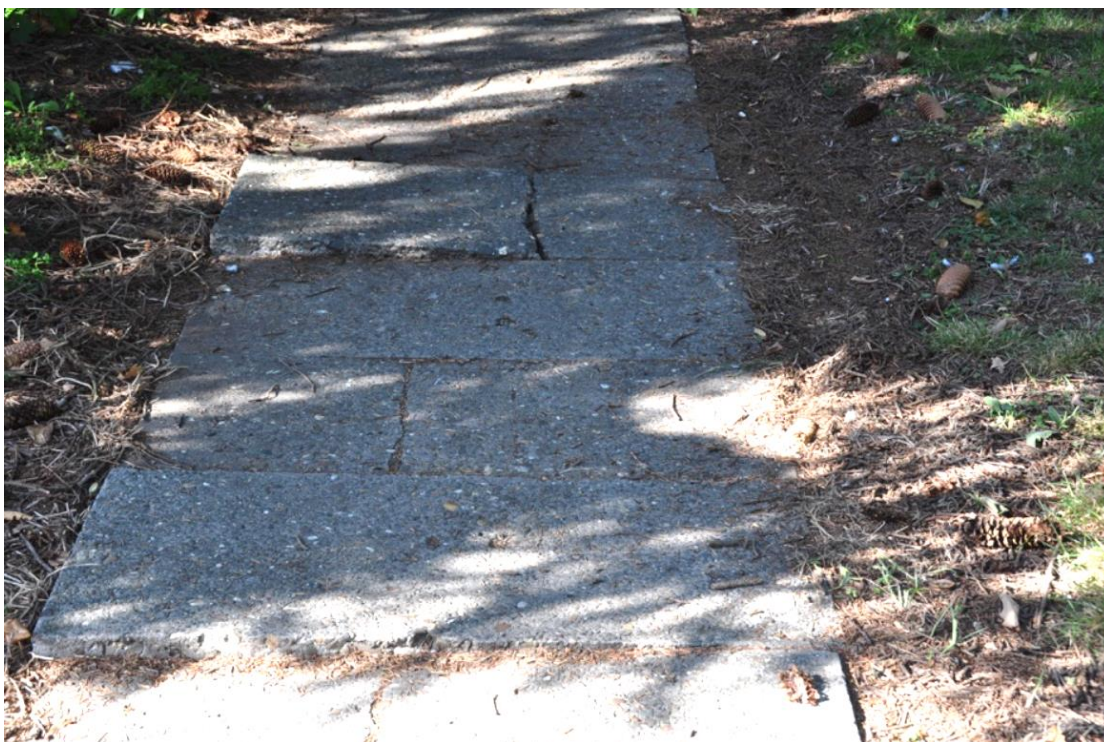
Afb. 161: Beschadigingen van het tuinpad in de achtertuin.
