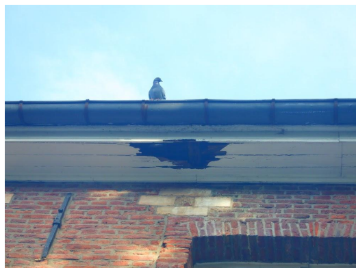
deels weggerotte kroonlijst
