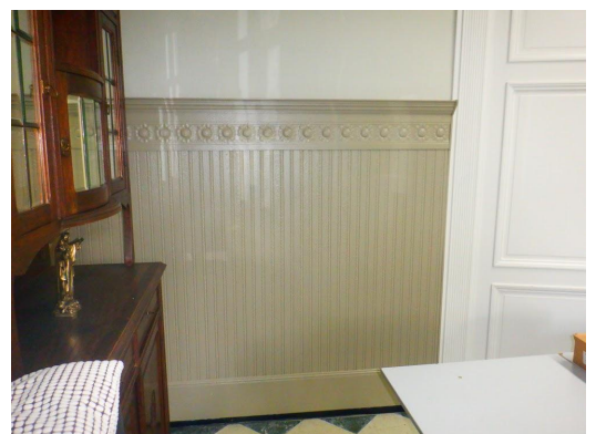
vermoedelijke asbesthoudende lambrisering
