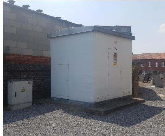
Elektriciteitscabine (zonder erfgoedwaarde).
