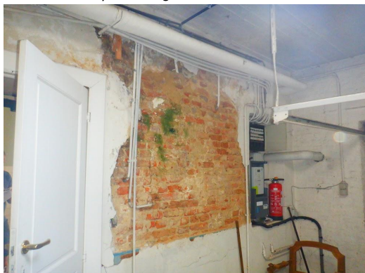
vochtsporen en afgefallen bepleistering in de garage
