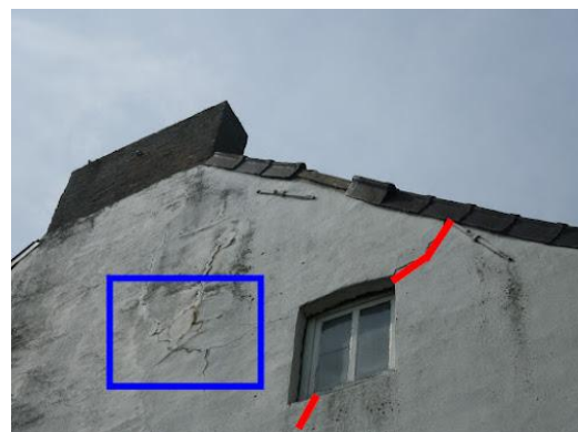
scheurvorming en loskomende bepleistering
