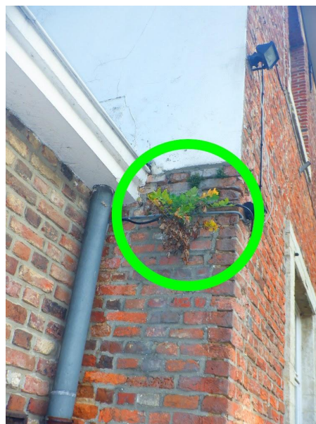
vochtsporen, uitvallend voegwerk en plantengroei
