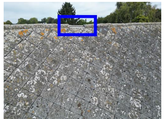
verdwenen nokstuk en ernstig verweerde vezelcementleien
